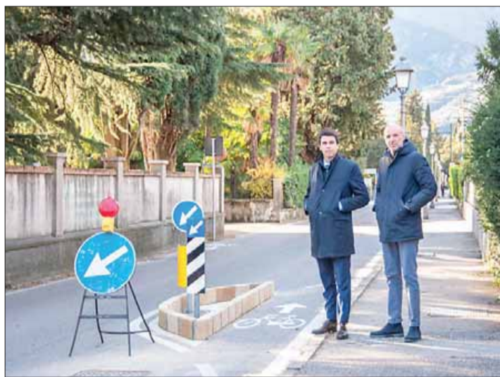
Tamburini e Pallaoro di fronte al pinch point montato in via Capitelli (Salvi)
